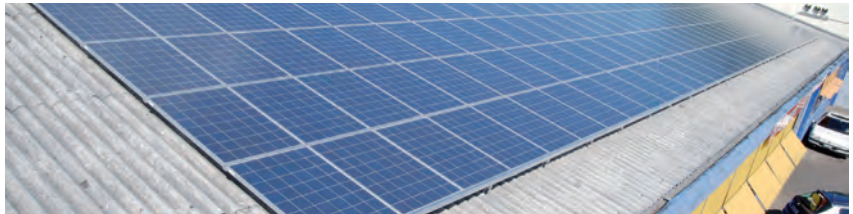
Die neue Solaranlage auf dem Garagendach des Autohaus Wederich, Donà AG in Muttens. «Es ist ein tolles Gefühl, seinen eigenen Strom zu produzieren», meint der Direktor Claudio Bacchetta.
