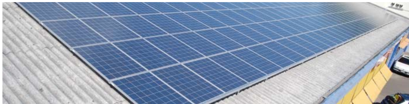
Die neue Solaranlage auf dem Garagendach des Autohaus Wederich, Donà AG in Muttenez. «Es ist ein tolles Gefühl, seinen eigenen Strom zu produzieren», meint der Direktor Claudio Bacchetta.
