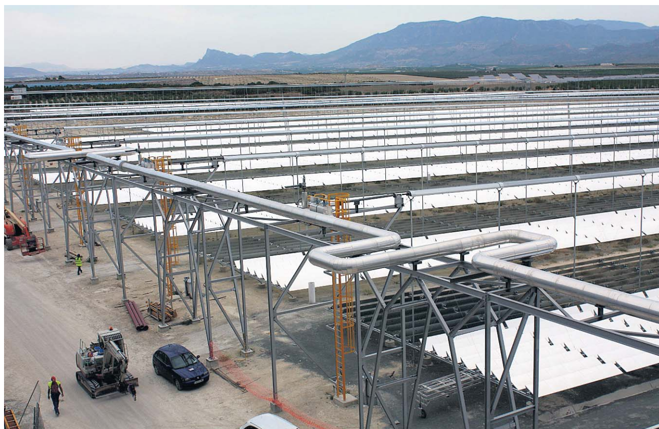
Nach Projekten wie dem EBL-Solarkraftwerk in Südspanien besteht heute eine hohe Nachfrage. DH
